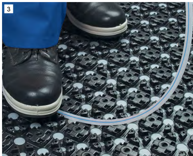
3) Paigaldage torustik vastavalt ruumi kujule ning valitud torusammule. Soovitavad torusammud on: vannitoad 50 mm, elutoad 150 mm, ääretsoonid 50-100 mm. Ärge ületage kontuuri maksimaalset lubatud pikkust 60m.
